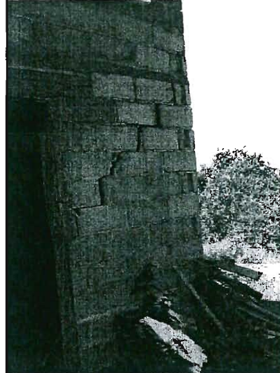
Uszkodzenia budynku mieszkalnego
