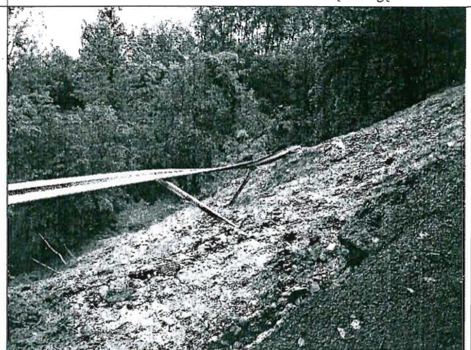
widok z drogi na osuwisko
