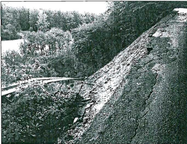
widok ku wschodowi na osuwisko niszczące drogę
