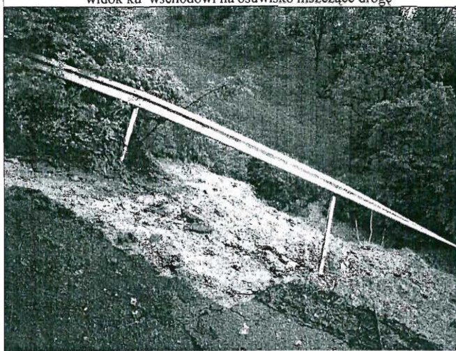
widok z drogi na osuwisko
