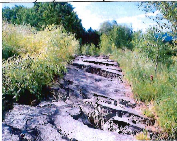
Zniszczona droga dojazdowa
