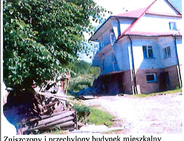
Zniszczony i przechylony budynek mieszkalny
