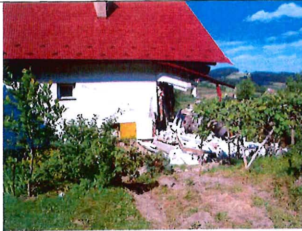
Zniszczony budynek mieszkalny
