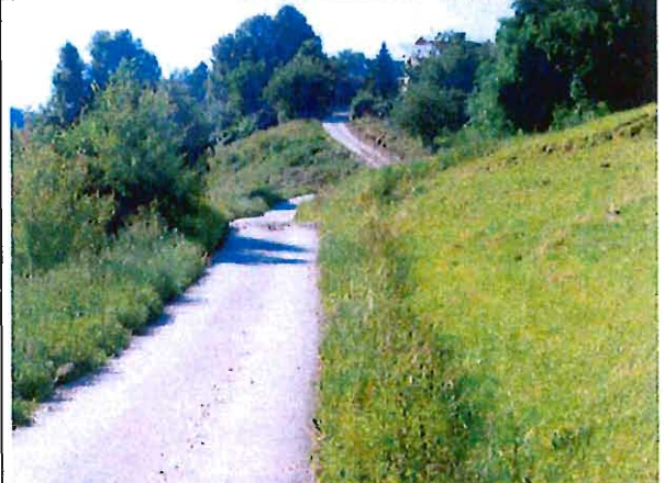
Zniekształcona droga dojazdowa na czole osuwiska
