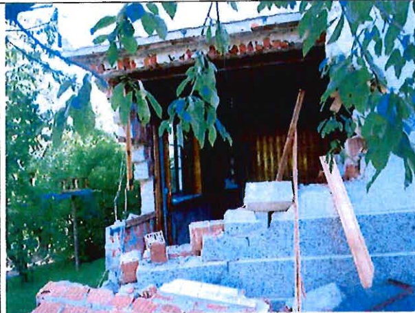
Zniszczony budynek mieszkalny w środkowej części osuwiska
