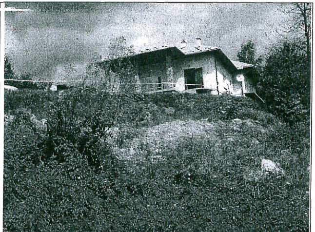
Widok na strefę skarpy głównej osuwiska i zabudowania mieszkalne ponad nią
