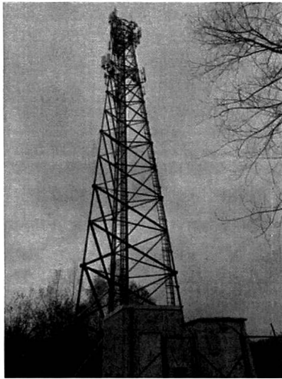
Widok obiektu wraz z zainstalowanym zespołem antenowym
