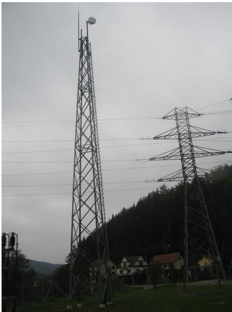
Zał. nr 1: Widok ogólny instalacji radiokomunikacyjnej.
