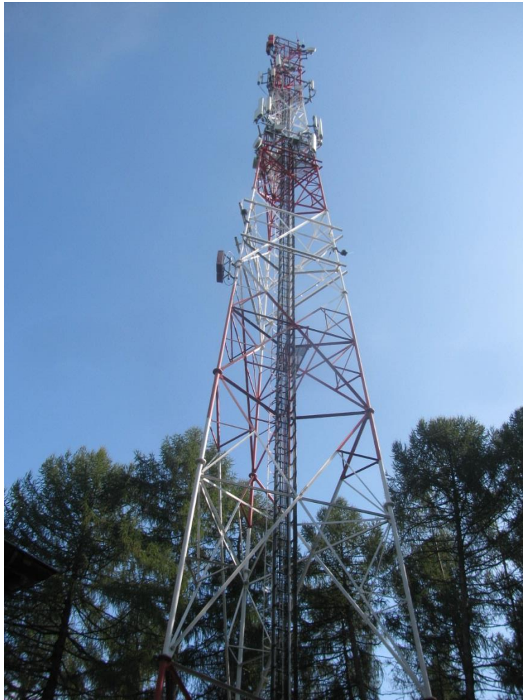
Zaf. nr 1: Widok ogólny instalacji radiokomunikacyjnej.
