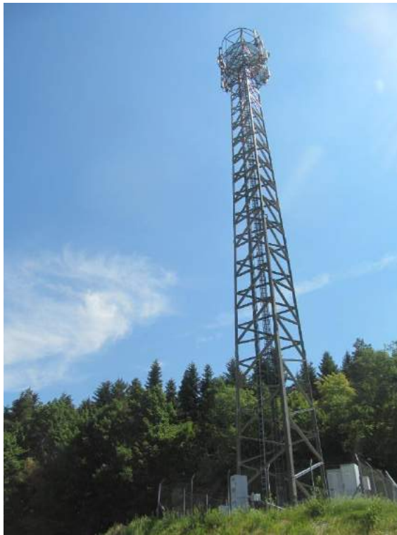
Zał. nr 1: Widok ogólny instalacji radiokomunikacyjnej.
