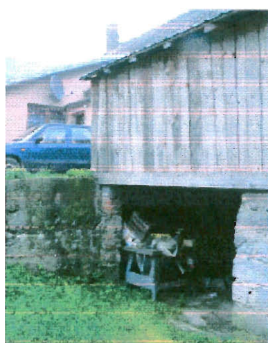
uszkodzenia budynku gospodarskiego
