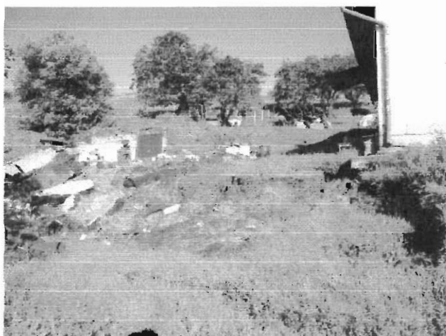
Zniszczony budynek gospodarczy i nowa skarpa
