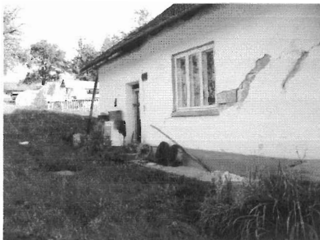
Uszkodzenia budynku mieszkalnego
