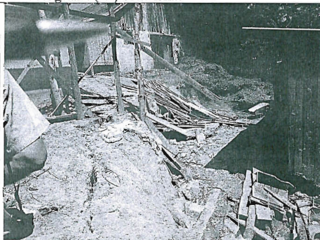
Skarpa główna osuwiska w rejonie zabudowań
