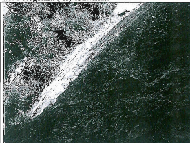
Skarpa główna osuwiska poniżej budynku Lipie 36
