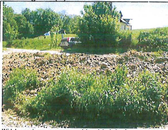
Widok na zniszczony przez osuwisko odcinek drogi
