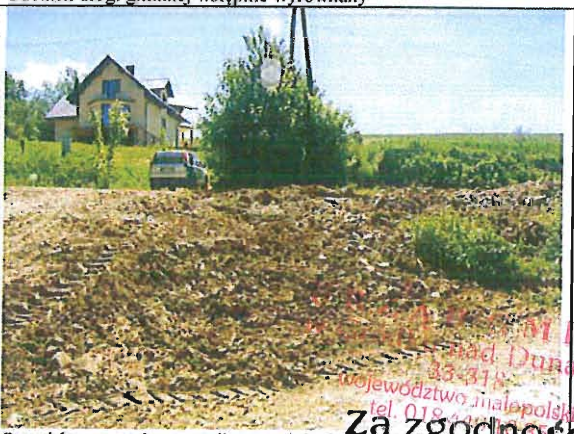
Osuwisko powstało w wyniku uwodnienia materiału przez wody opadowe spływające drogą dojazdową.
